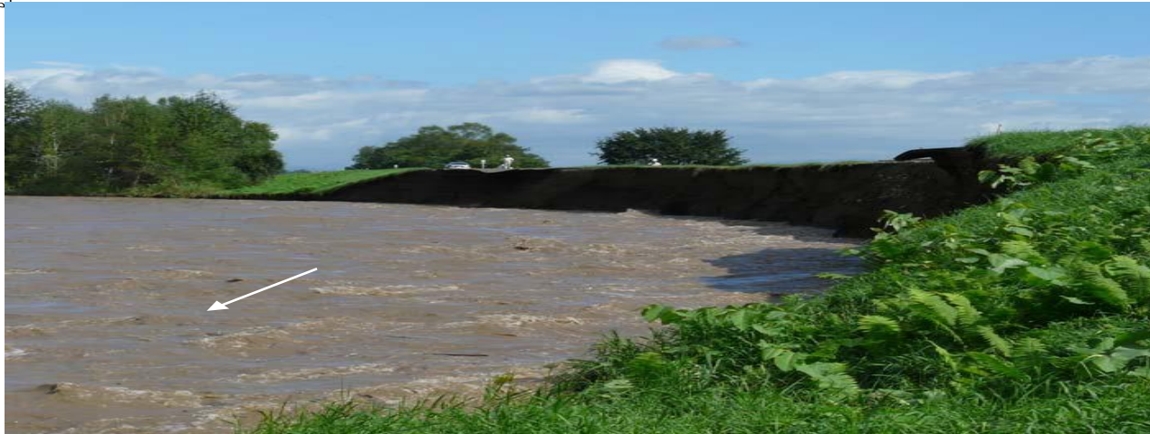
写真3-2 堤防の一部流出箇所（下流側から撮影。H23.9.7 AM9:24撮影）
